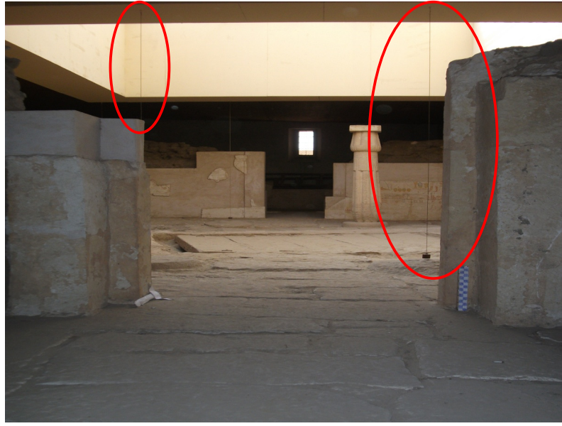
شكل 14-خيط الشاغول يتدلى من سقف المقبرة حيث استخدم كوسيلة لمراقبة هبوط السقف.
